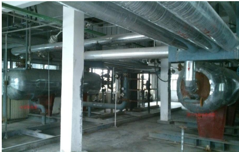
清淨废次钠回用装置
