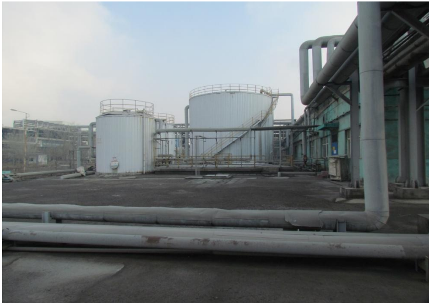
固碱蒸发的凝结液回收装置
