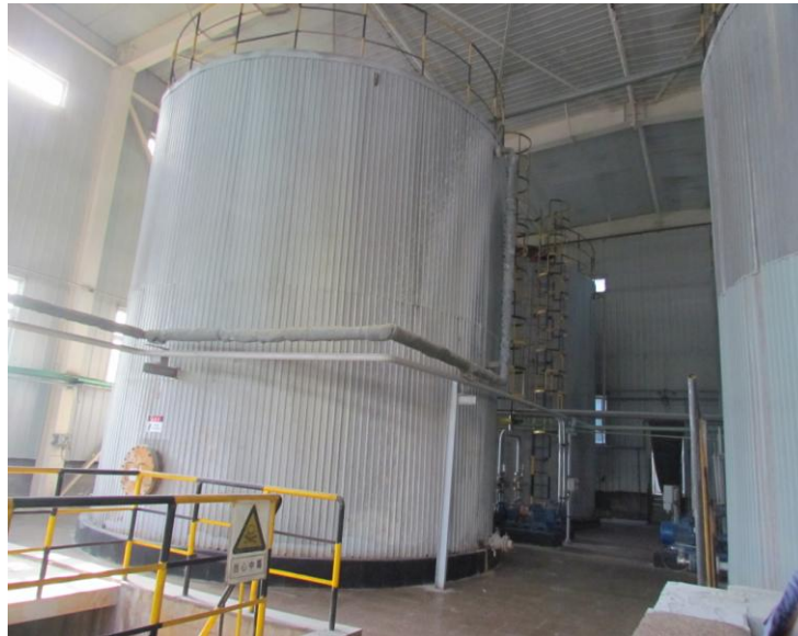
氯碱/PVC 界区蒸汽换热后的冷凝液回收装置
